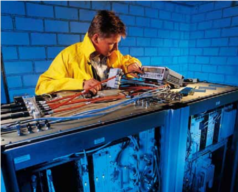
R&S®NRT用于移动无线电基站的安装中
